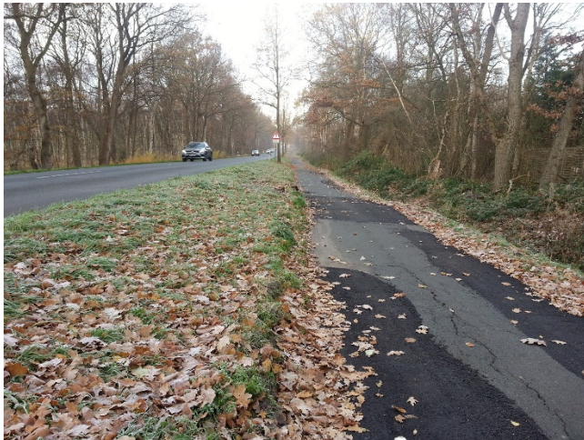
Bild 1: Verformungen, Risse und Flickstellen auf dem Radweg
