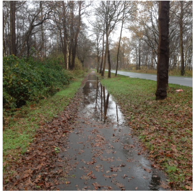
Bild 2: Überfluteter Teilbereich des Radweges
