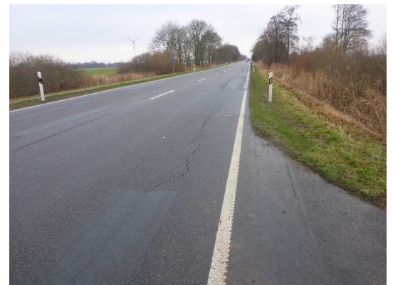
Bild 2: Risse, Verformungen und Flickstelle
